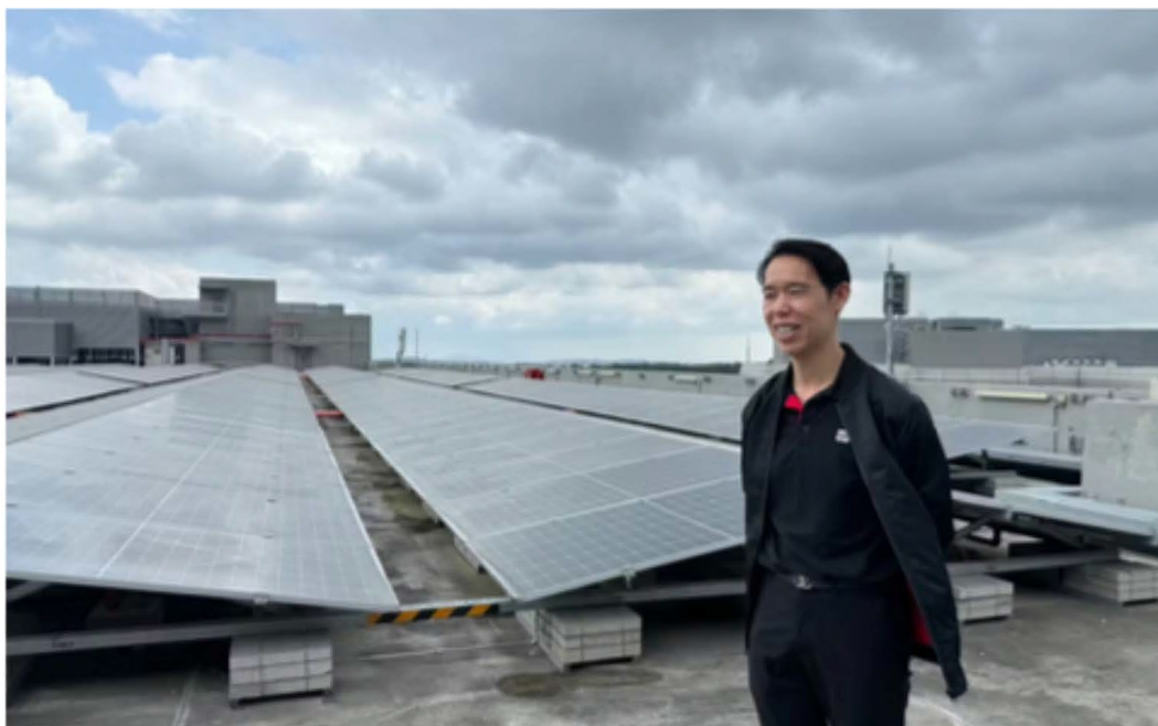
10階建て校舎の屋上には太陽光パネルが設置され、キャンパスの電力需要の4%を供給する
